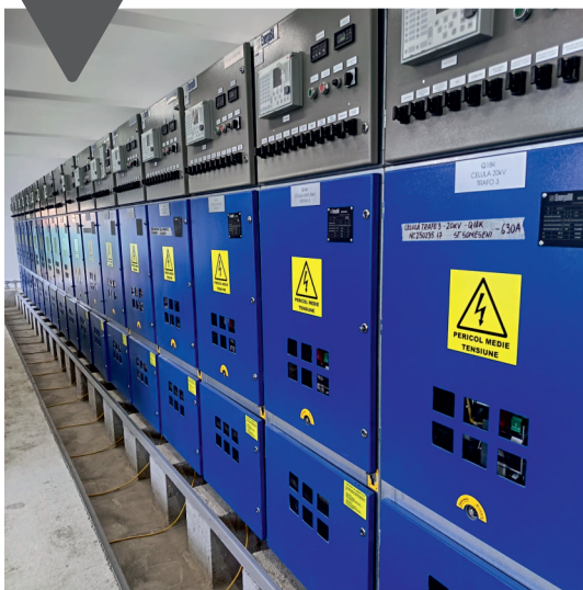
Stația de Transformare 110/20/10 kV Someșeni (interior)
